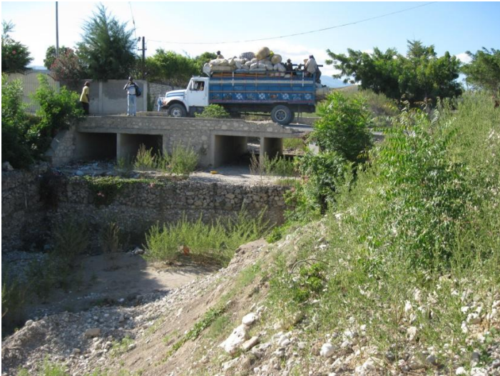
Vue après le passage du cyclone Hanna dans la ravine Durée sur lequel repose le pont Celi dans le quartier de Dolan aux Gonaïves on observe un affouillement du radier de l'ouvrage pouvant induire des basculements et sa rupture
