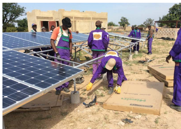
Figure 11. Mini centrale solaire installée à Bankoumana
