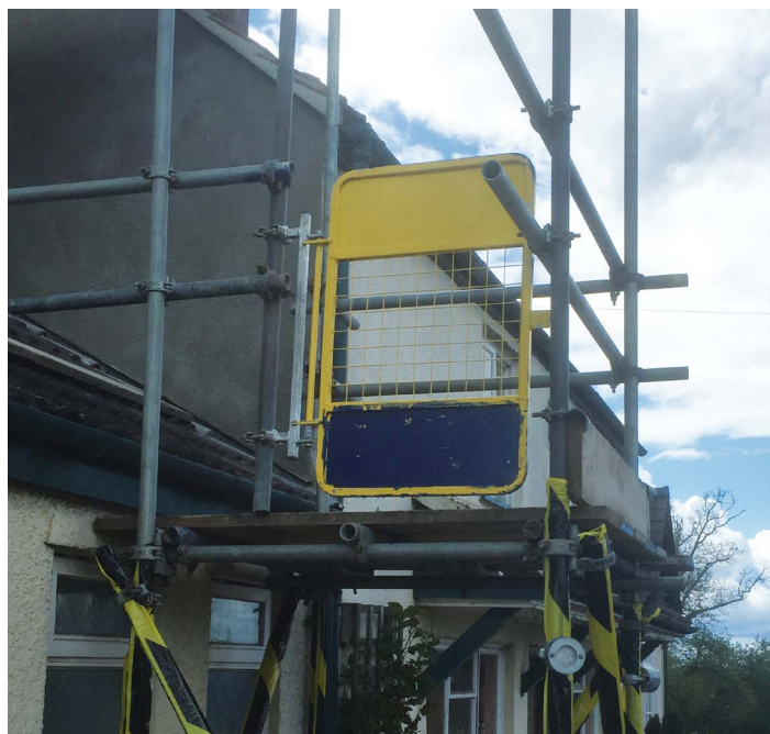
Ilustración 13. Compuerta con autocierre de un punto de acceso al andamio
