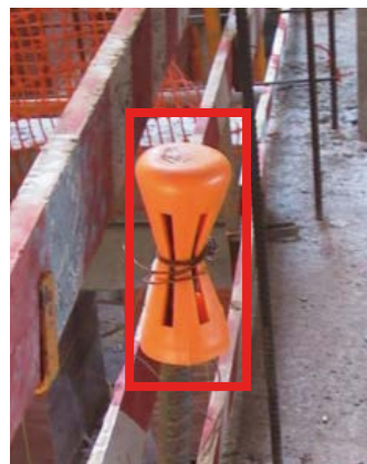
Ilustración 6. Barras de refuerzo tapadas para controlar el riesgo de empalamiento
