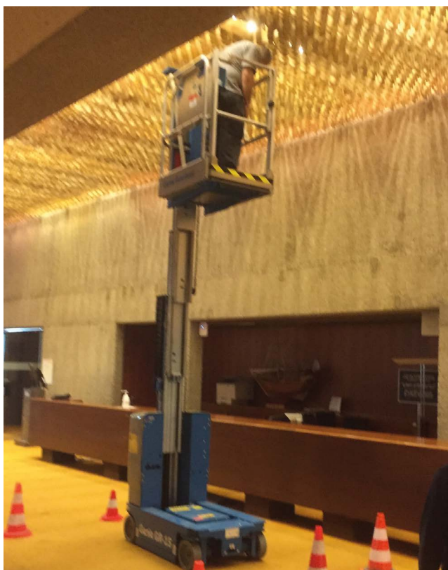
Ilustración 18. Plataforma elevadora móvil en uso en una oficina para dar mantenimiento a las luminarias
