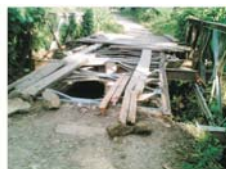
Jalan berlumpur dan jembatan rusak di Nias akibat kurangnya pemeliharaan.
