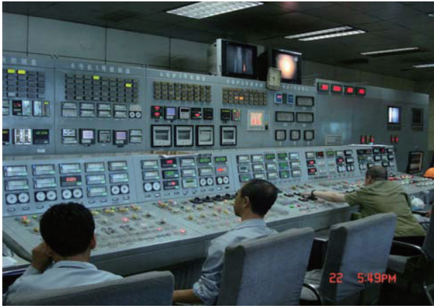
10万千瓦火电厂集控室
