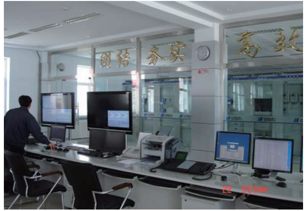
发电厂集控室
