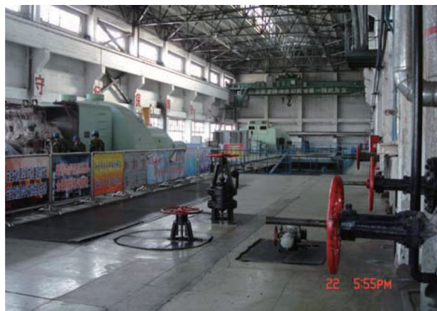
火电厂锅炉车间
