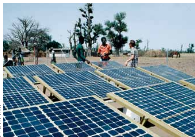
Panneaux solaires voltaïques au Sénégal
