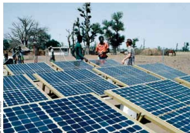
Panneaux solaires voltaïques au Sénégal
