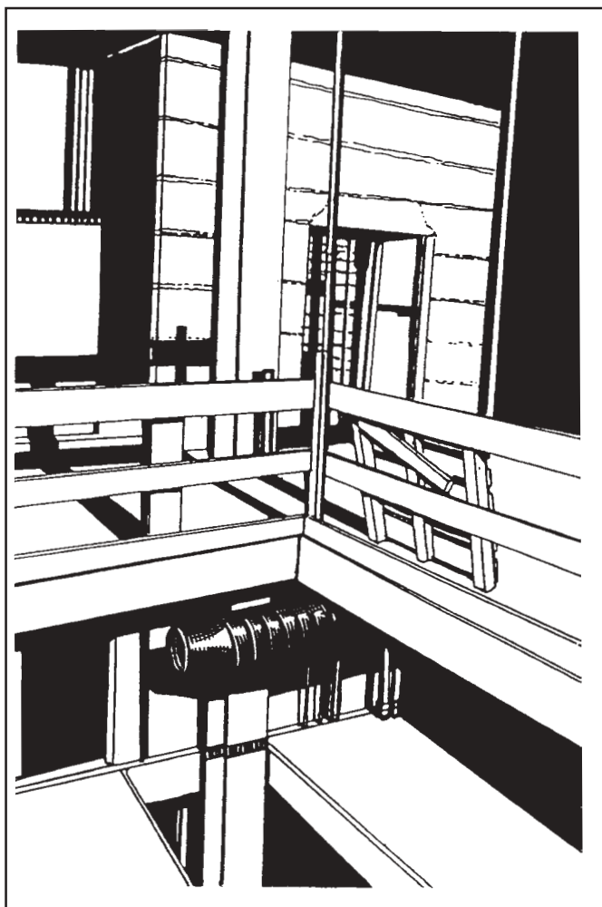
Figura 5. Protección de rebordes: Las barandillas y tabloncillos protectores de ples colocados en torno de las aberturas del piso y de las plataformas de trabajo previenen la caída de los trabajadores.
