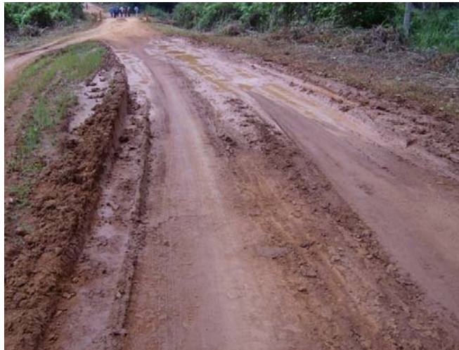
Photo 5 : Bourbier au deuxième point critique PK 01+000 (bis)
