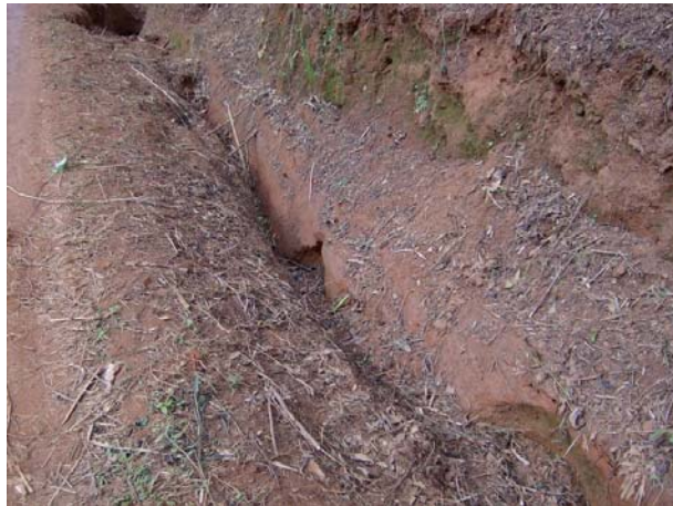
Photo 7 : Erosion du fossé côté droit au PK 00+150
