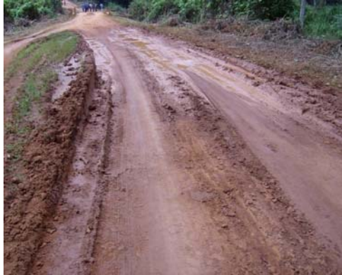
PK 01+000 (Bourbier) Deuxième point critique
