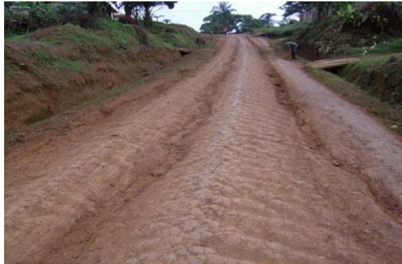
Photo 6 : Ravinement longitudinal au Point intermédiaire PK 00+510
