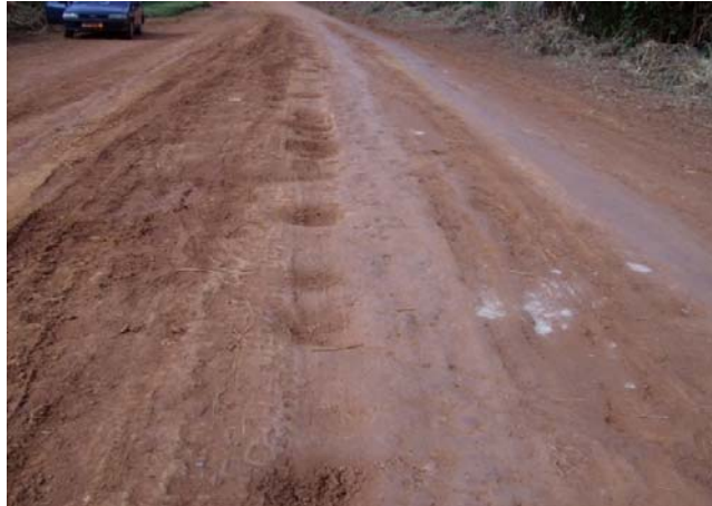
Photo 2 : Nids de poule au premier point critique PK 00+000
