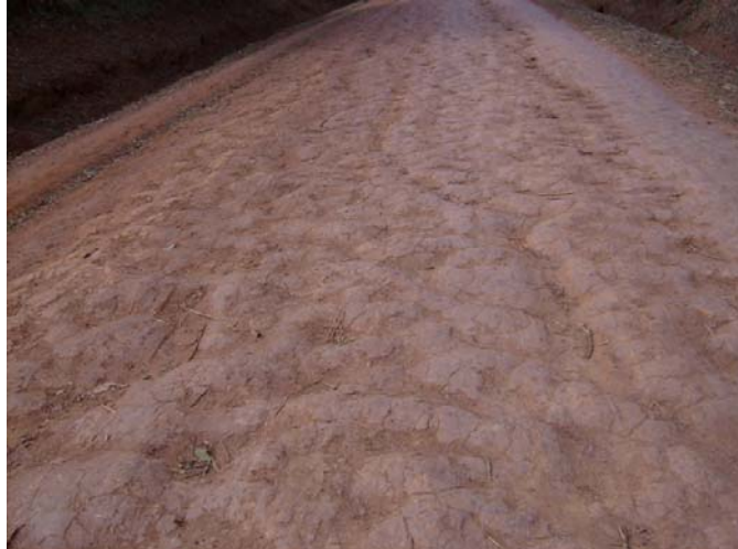
Photo 3 : Tôles ondulées au premier point critique PK 00+200
